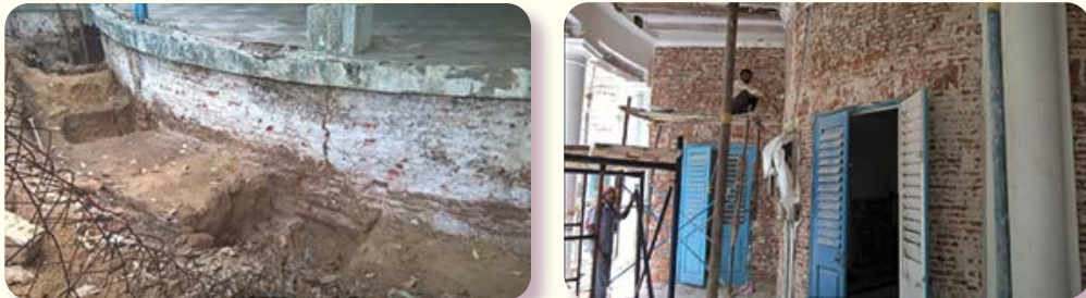
Links een scheur in de fundering, rechts het schoonmaken van de muren van cement pleister
