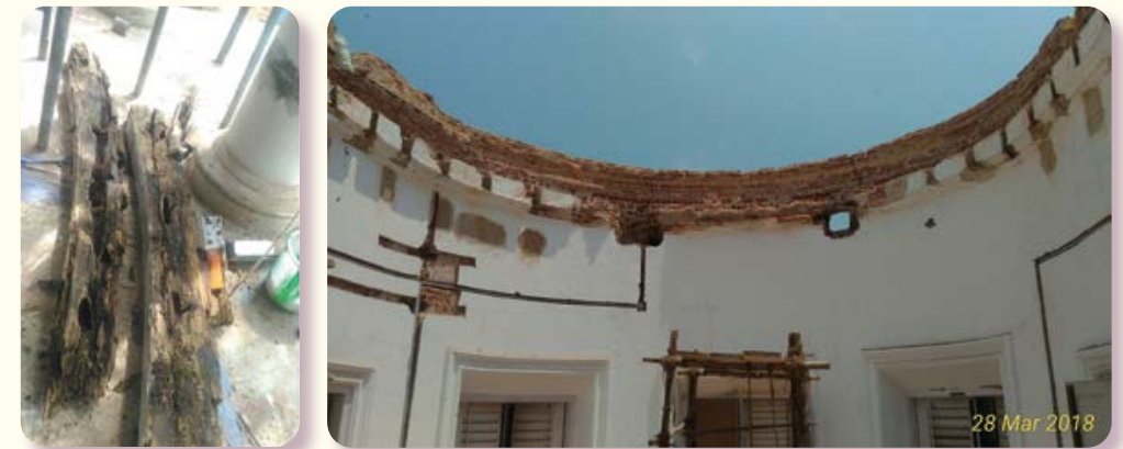
Links een deel van de houten balken en rechts wordt het dak vernieuwd
